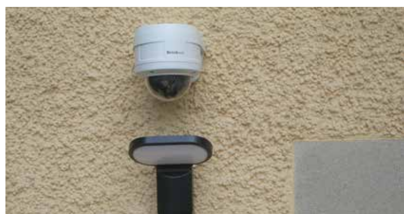
Datenübertragung über WLAN oder Kabel? Diese Frage muss man sich stellen, wenn eine Videoüberwachung installiert werden soll. BILD PROLIVING SYSTEMS AG
